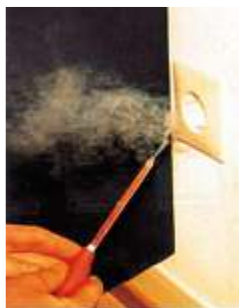
Prise non étanche à l'air Undichte Steckdose
